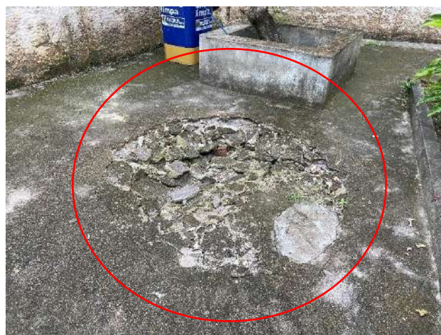
Foto 8 – Piso da área externa danificado.
