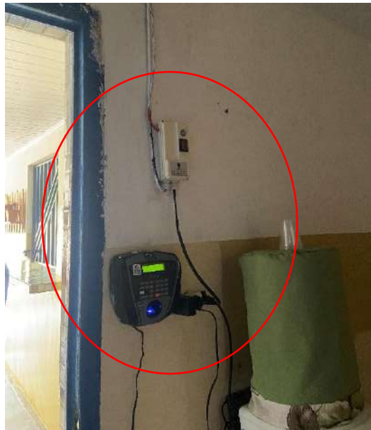
Foto 14 – Pontos de tomada insuficientes.
