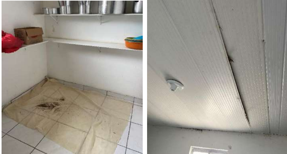
Foto 11 – Forro da despensa danificado.
