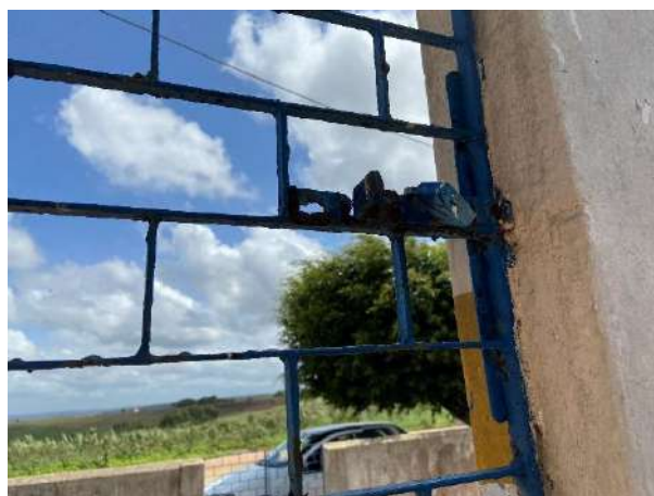
Foto 5 – Grade de entrada danificada.
